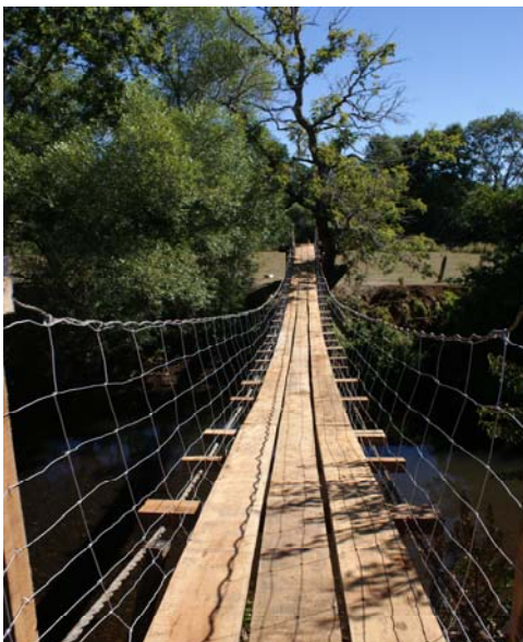
Rodado y malla de protección pasarela Collín Bajo
